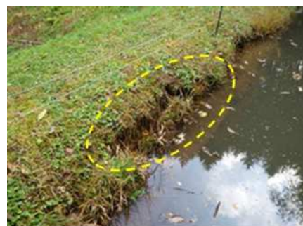
巣穴による「ため池堤体の損壊」
