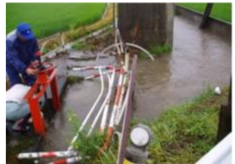
ゲートへのごみや流木の流入状況
