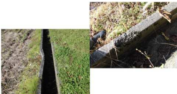
機能診断により劣化が確認された水路
