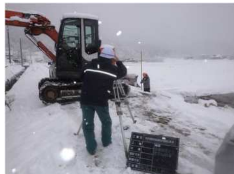
土地改良区の職員が長寿命化工事の施工状況の確認をしている様子
