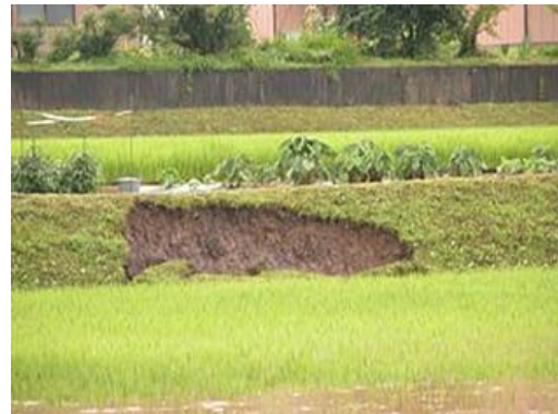
法面の崩壊状況
