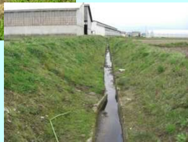
水路側壁の倒壊
