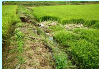
畦畔崩落及び農地土砂堆積
