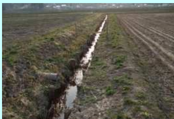
老朽化した水路
