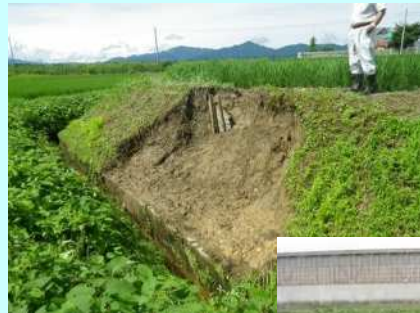
水路法面の崩壊
