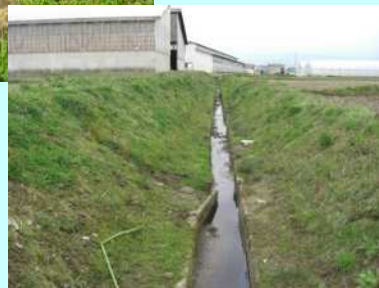
水路側壁の倒壊
