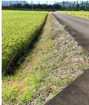
未対策の路肩
