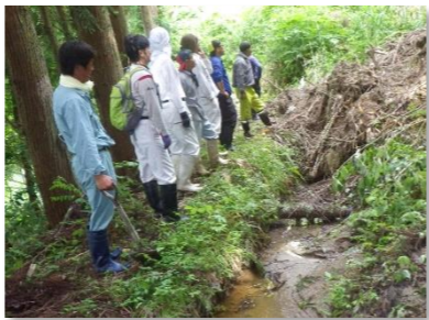
赤倉湯原堰：被災状況調査
