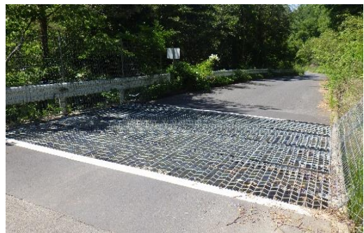
鳥獣被害対策（グレーチング）
