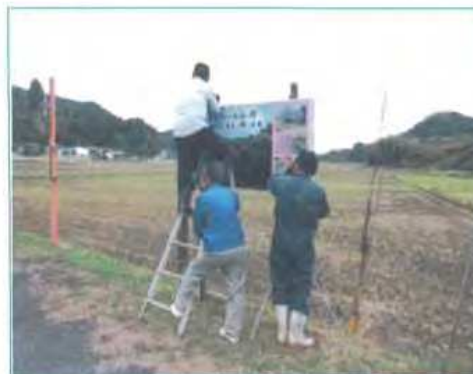
9月6日の深夜に九州西部を北上した台風の被害で支柱が折れ、破損していた啓発看板の支柱を鉄角パイプで加工し、11月19日によく建て付けを行いました。
