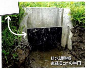
水を貯めるときは穴のない堰板を入れる
